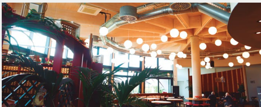
Weinbuch Butcher's Shop. Shop – Restaurant. Öpfingen, Tyskland. VRF, til bolig og køling.
